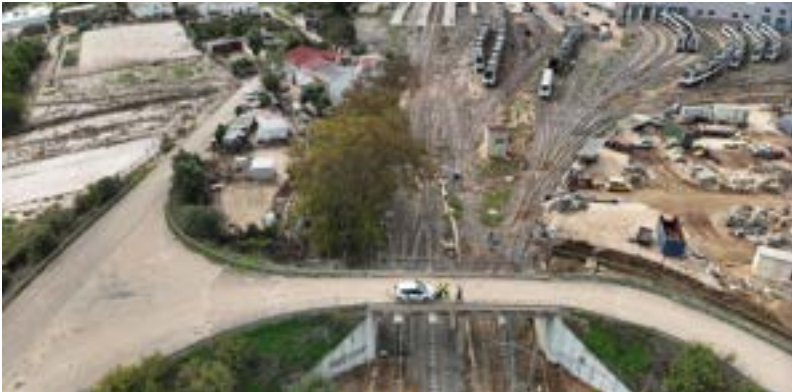
Trazado ferroviario después de los daños ocasionados por la DANA en Valencia. La aplicación de esta tecnología permitió georreferenciar la vía y evaluar los daños en las labores de reconstrucción.
